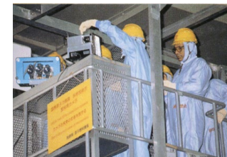
監視装置の保守管理
