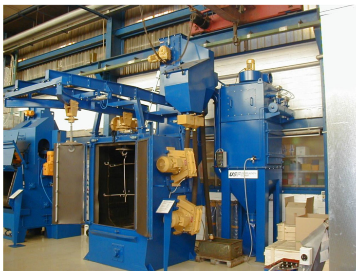
図 5.7 CARLA 施設内にある循環式ブラスト設備
