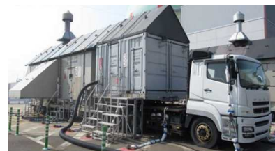
代替非常用発電機
