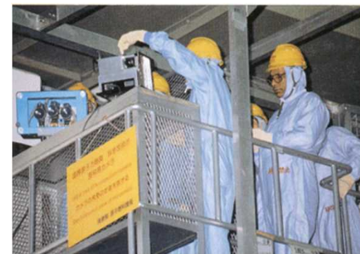
監視装置の保守管理
