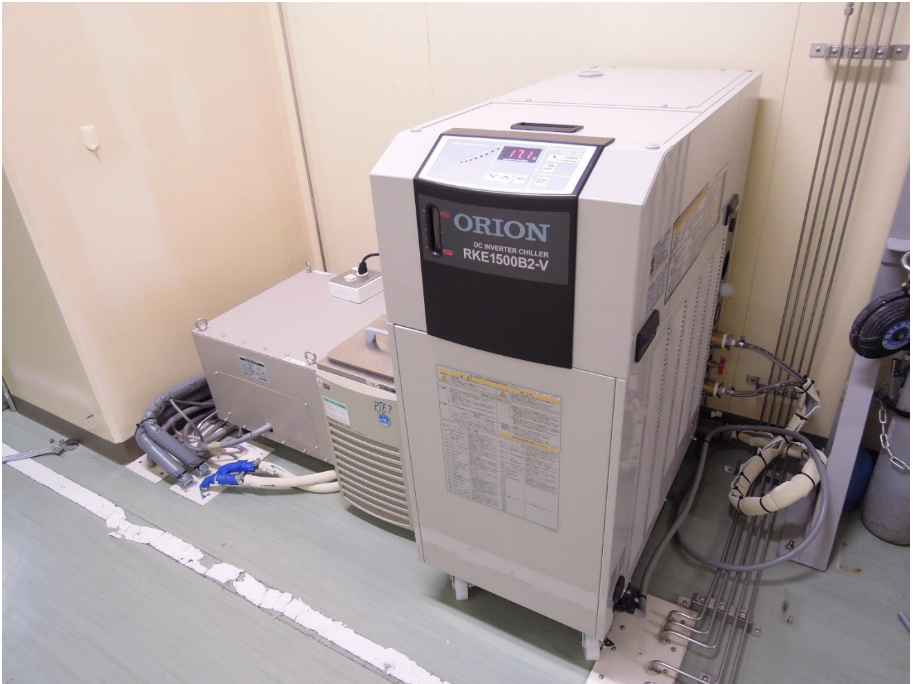
図-3. 2: サービスエリアに設置した冷却水循環装置とトランス
