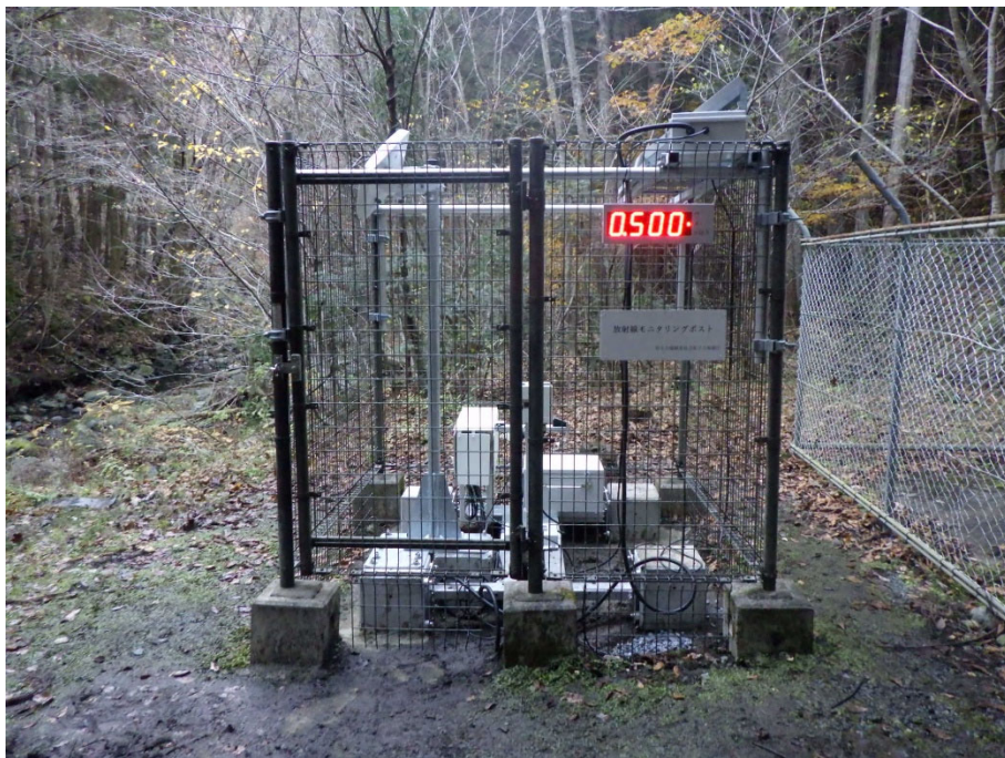
図 2-10-10 (6) 更新後の可搬型モニタリングポスト (高の倉ダム助常観測所 (南相馬市) : 2024 年 11 月 28 日撮影)
