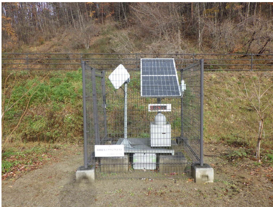
図 2-10-10 (3) 更新前の可搬型モニタリングポスト (八木沢芦原多目的集会所 (飯舘村) : 2024 年 11 月 27 日撮影)
