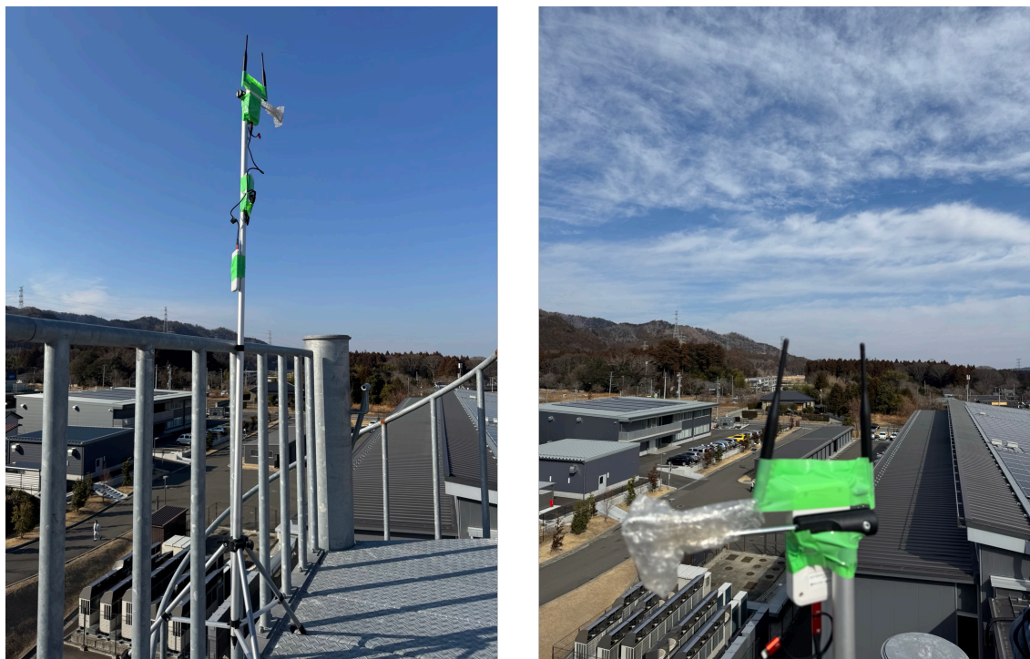
図 48 災害対策機能棟屋上に設置した Router の全景（左）とアンテナ位置から中継 6 を眺めたところ（右）。中継 6 が直接視認できる位置にある。
