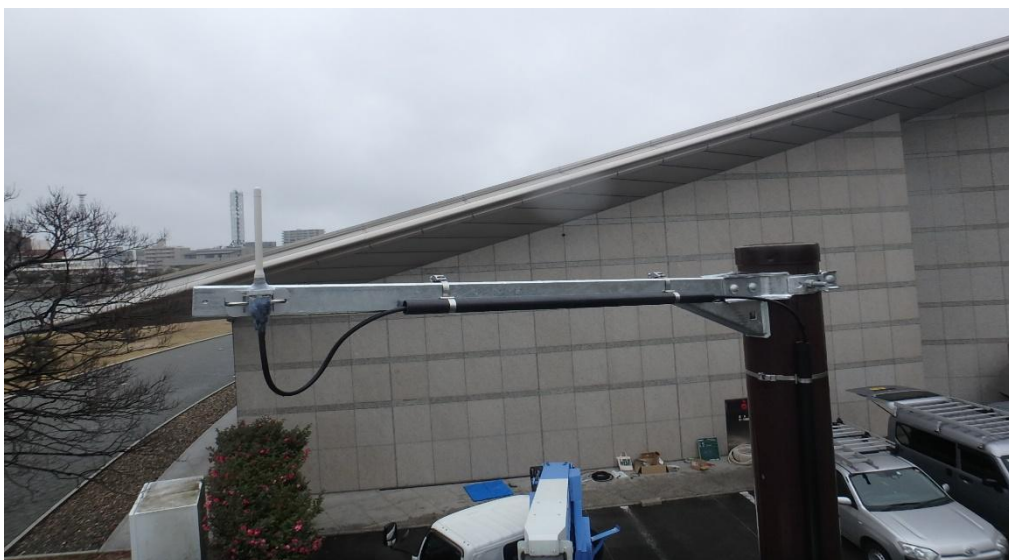
図 3-13 アンテナ取り付け位置
