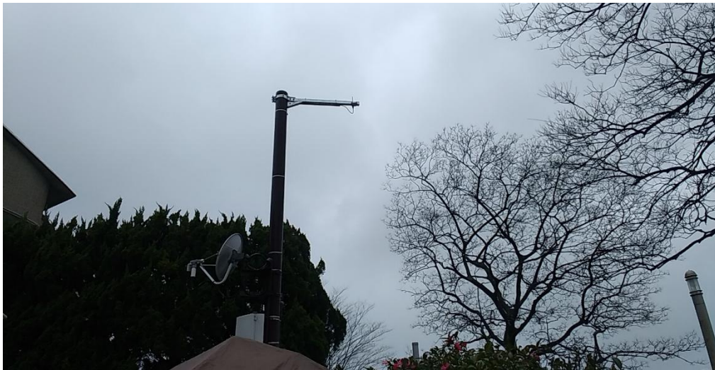
図 3-12 アンテナ取り付け位置
