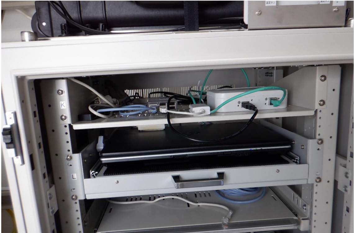
図 3-14 ZETA 通信機器の設置
