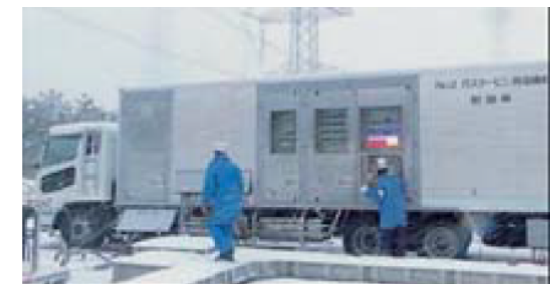
常設代替交流電源設備 (設置場所に固定し常設化)
