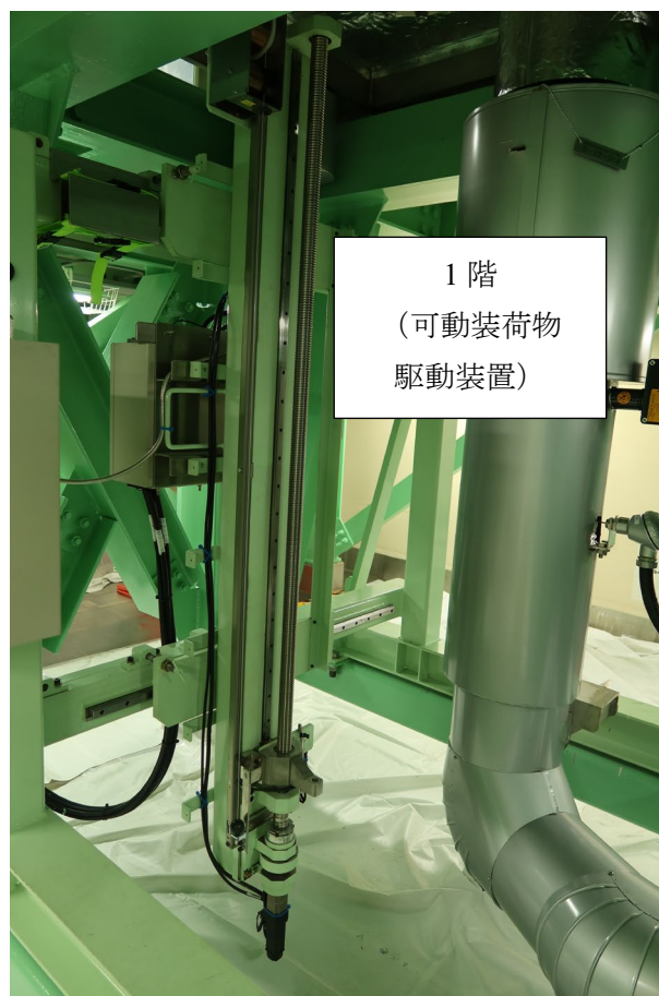
図 4.1.2-1(4) STACY 更新炉可動装荷物駆動装置 (据付後)
