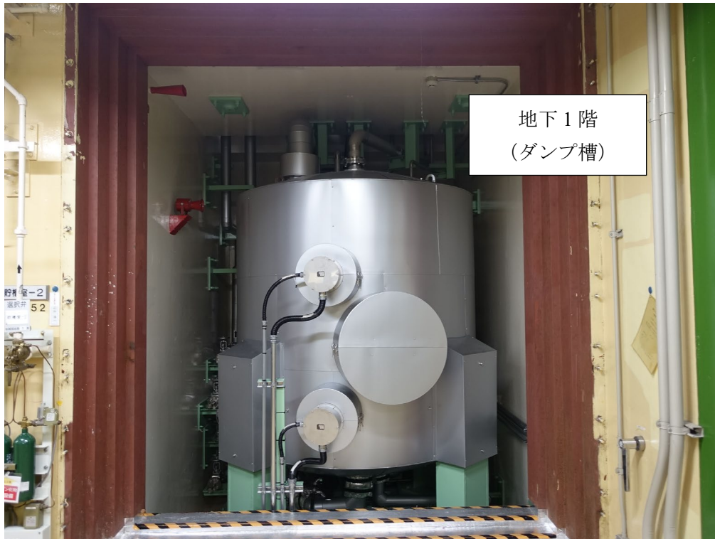
図 4.1.2-1(3) STACY 更新炉ダンプ槽 (据付後)
