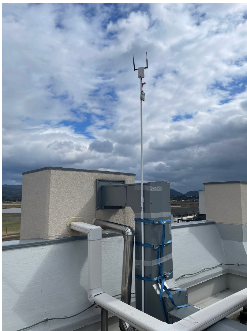
図 6 島根県保健環境科学研究所屋上に設置された中継局。地上高は約 20 m で、この中継局がメッシュネットワークの事実上の起点となる。
