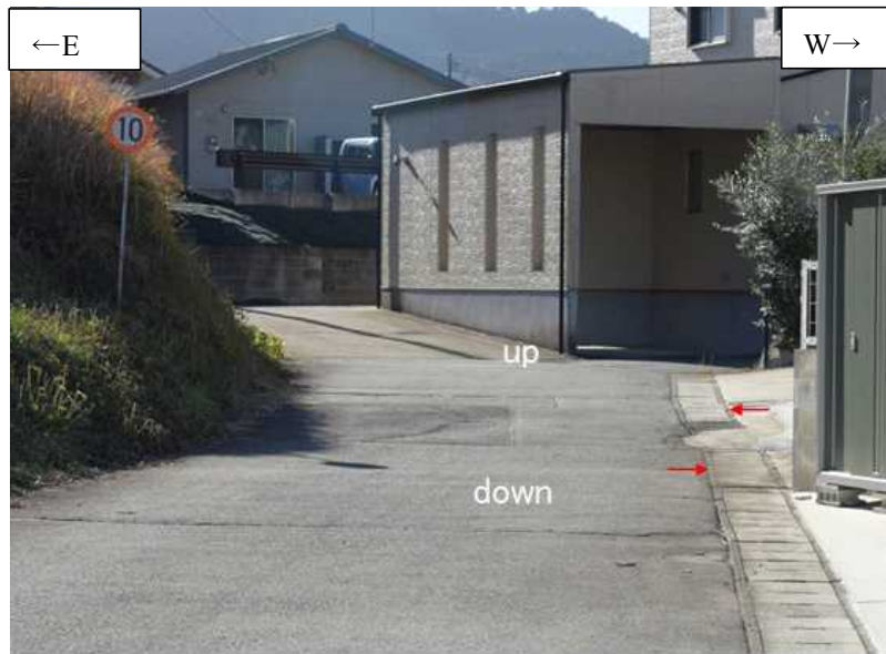
図 2.4.59 トレンチ周辺の変位・変状
