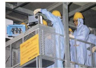
監視装置の保守管理
