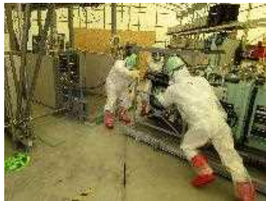
堆積物除去装置 （低圧水）設置
