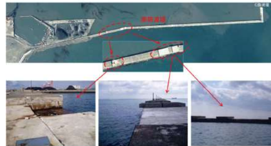
外港地区 南防波堤 (平成23年3月28日撮影) 上部工欠落
