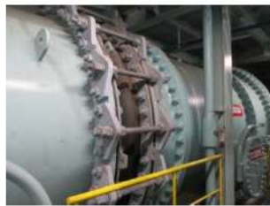
循環水管伸縮継手
