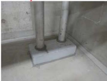
電線管貫通部
