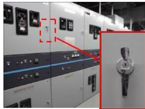
電源盤の施錠
