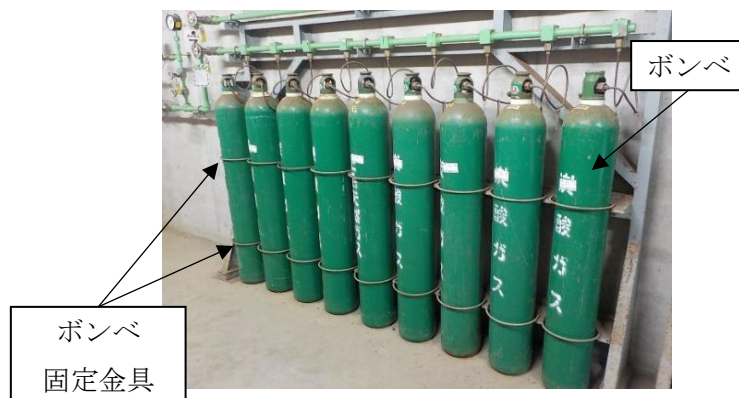
【7号機ボンベ建屋】 二酸化炭素ボンベ
