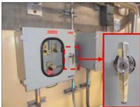
制御盤の施錠
