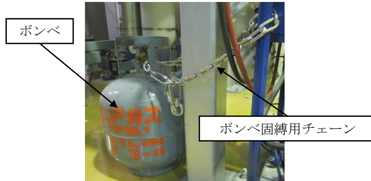
【技能訓練施設 技能訓練棟】液化プロパンガスボンベ
