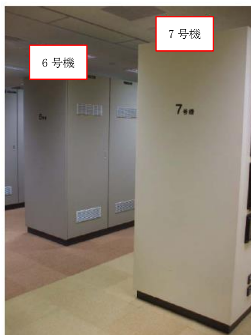
図2-26 制御盤（裏盤）の色別管理
