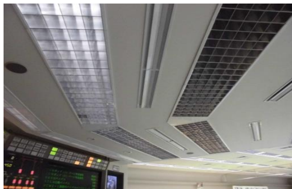
図1-3 中央制御室照明
