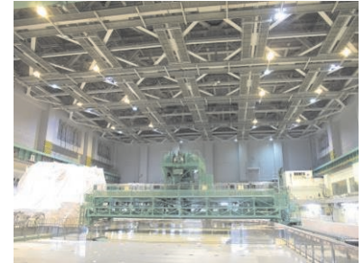
使用済燃料貯蔵プール 上部天井
