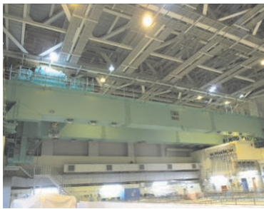
原子炉建屋クレーン
