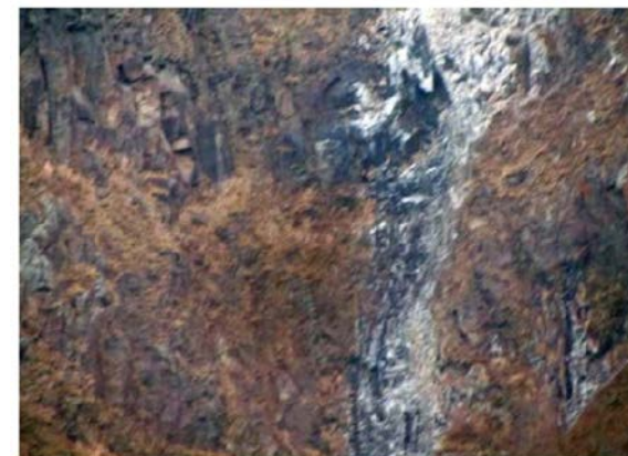
写真3: (写真2の拡大) 柱状節理の発達した堅硬な溶岩が露岩し、滑落崖等の地すべりを示唆する状況は認められない。
