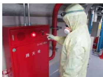
消火ポンプ起動 (燃料取扱棟 T. P. 33. 1m)
