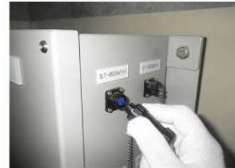
ケーブル接続 BOX
