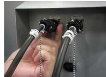
検出器用ケーブル接続
