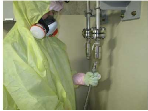
可搬型格納容器内水素濃度計測ユニット接続 (周辺補機棟 T. P. 24. 8m)
