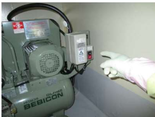
可搬型代替ガスサンプリング圧縮装置停止 (周辺補機棟 T. P. 24. 8m)
