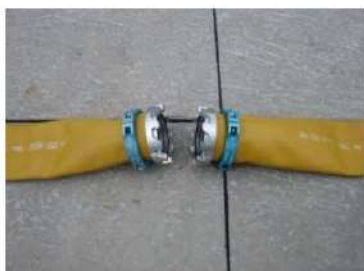
可搬型ホース(150A)接続前
