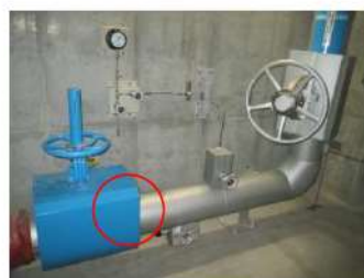
可搬型温度計測装置（格納容器再循環ユニット入口温度／出口温度）設置場所（排水側） (周辺補機棟 T. P. 17.8m)
