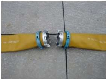
可搬型ホース(150A)接続前
