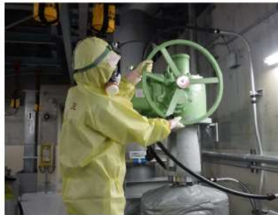
余熱除去ポンプ RWSP 側入口弁及び余熱除去ポンプ RWSP/再循環サンプ側入口弁手動操作 (原子炉補助建屋 T. P. 2. 8m)
