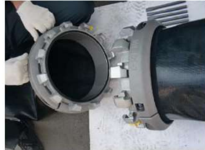
可搬型ホース(300A)接続
