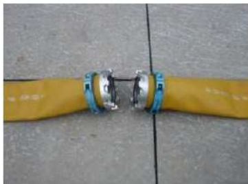
可搬型ホース (150A) 接続前
