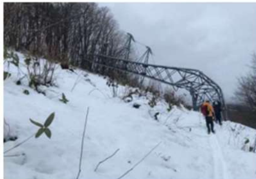
大雪による鉄塔倒壊事例 ※3
