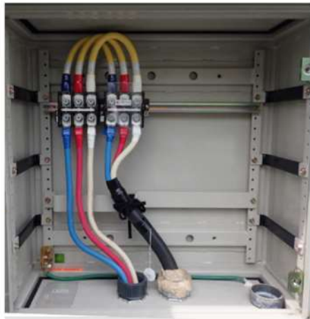
ボルト・ネジ接続 (代替直流電源)
