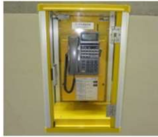
運転指令設備（警報装置を含む）
