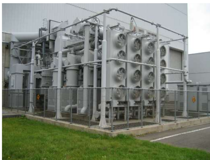
第1図 変圧器外観
