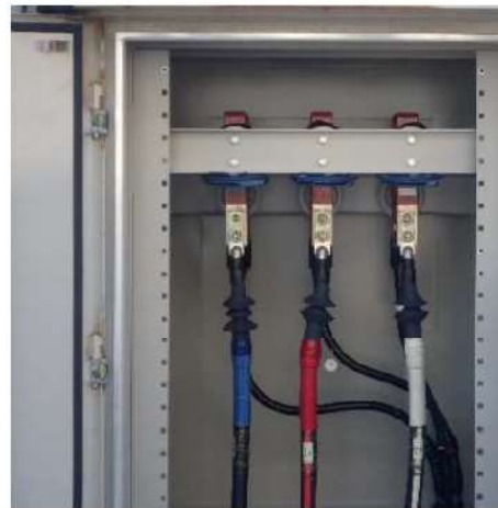
ボルト・ネジ接続 (代替交流電源)
