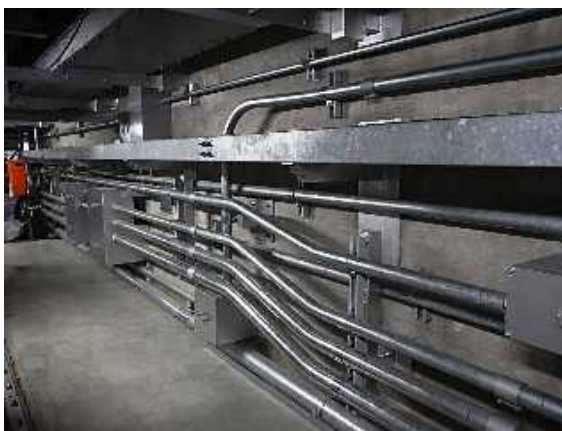
ケーブルトレイ，電線管の例
