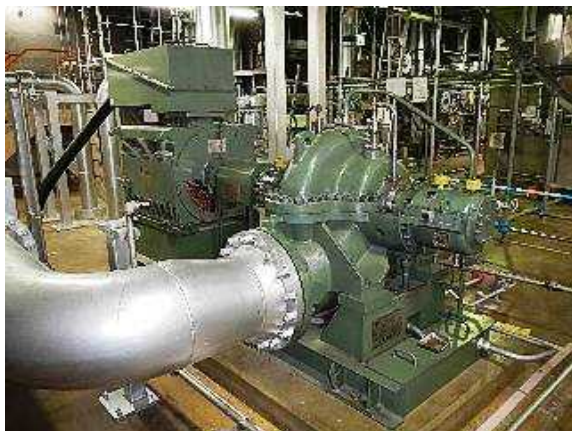
ポンプ，配管，支持構造物の例
