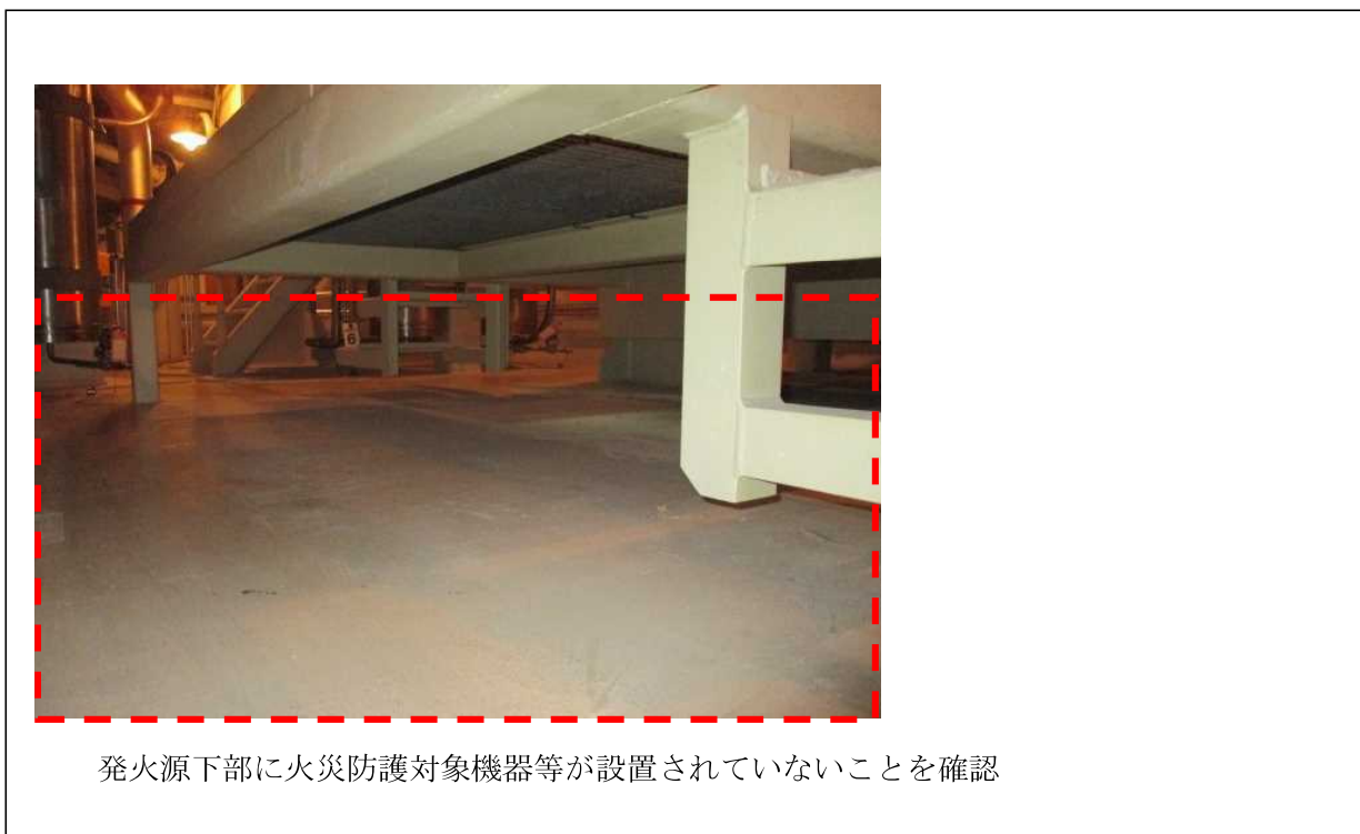
図4 主蒸気内側隔離弁下部
