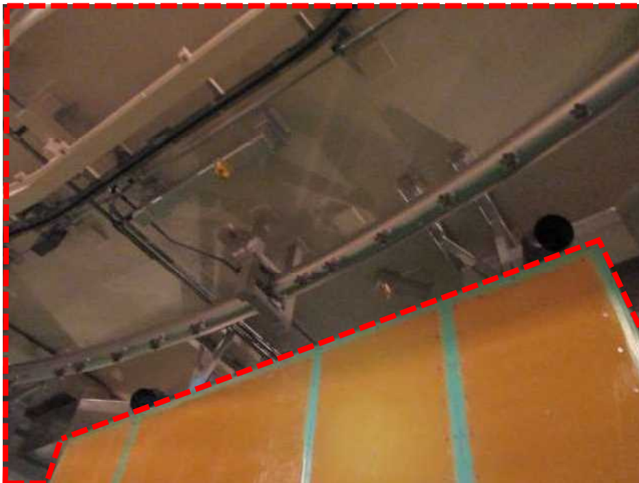
格納容器上部に火災防護対象機器等が設置されていないことを確認
