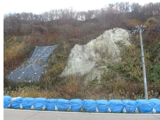
C05:ブロック7末端の崩壊地形 (古平層の凝灰岩)。
