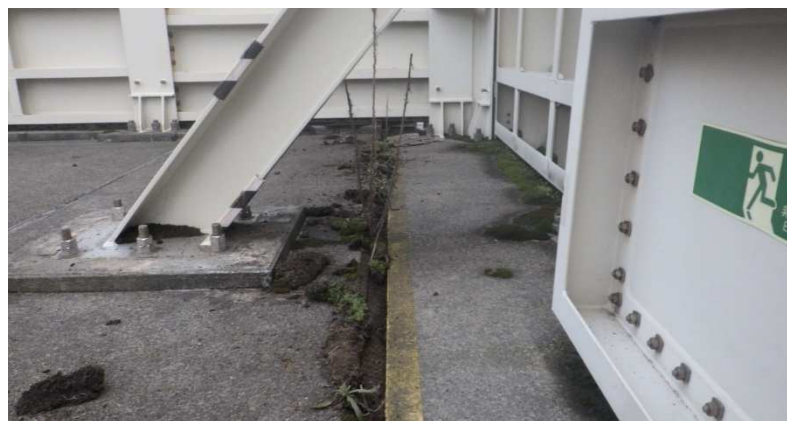
1号機防潮壁の基礎地盤の空隙
