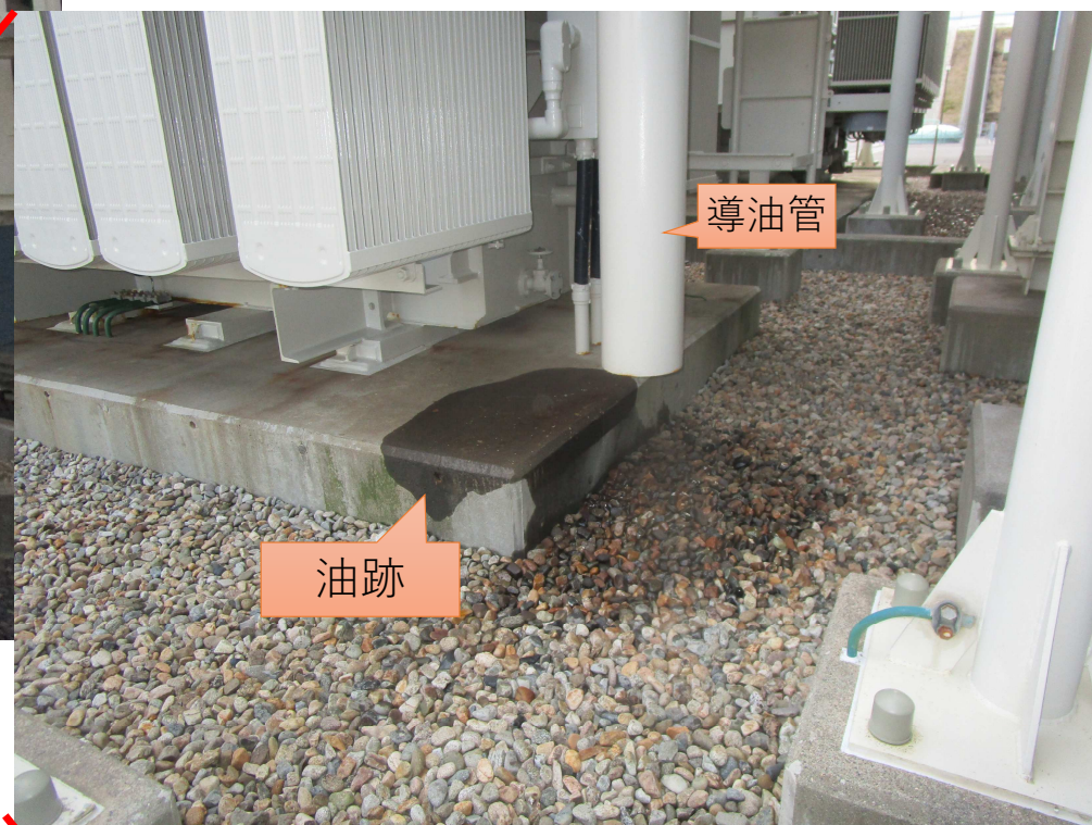
2号機 励磁電源変圧器の油漏れ
