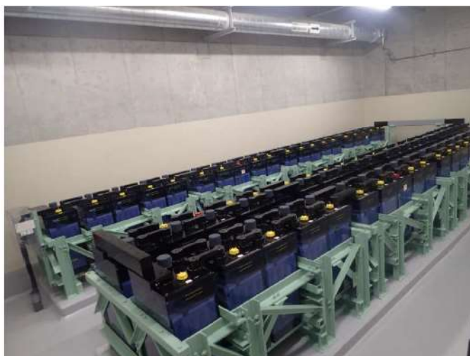
第 1-29 図：安全系蓄電池室の状況
