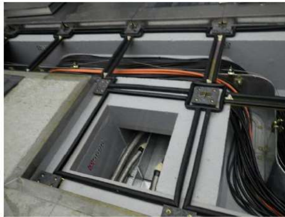
第 1-27 図：フロアケーブルダクトの状況
