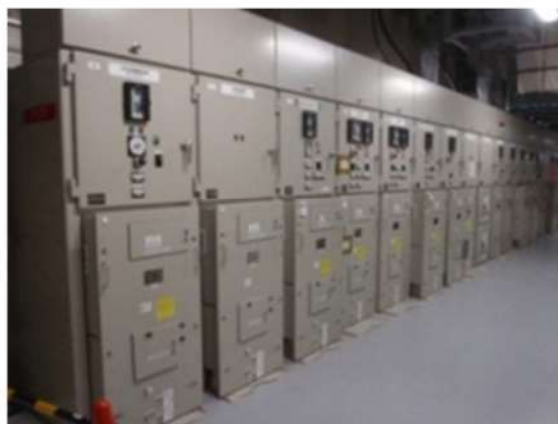
第 1-28 図：3A-安全補機開閉器室の状況
