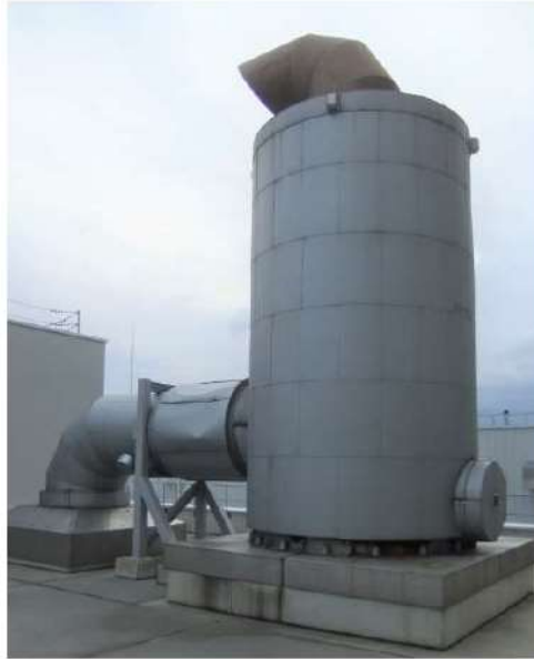
第3図 ディーゼル発電機排気消音器及び排気管
