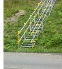
階段（単管パイプ製）
