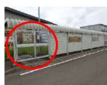
ポリカーボネート窓, 屋根
