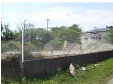
フェンスの被害状況
