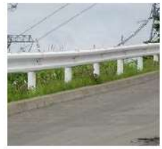
ガードレール
