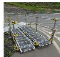
階段（単管パイプ製）
