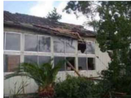
倉庫の窓ガラスと屋根の被害状況
