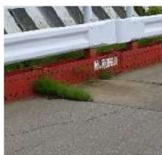
ガードレール
