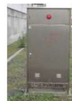
消火栓（ホース格納箱）
