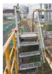
階段（単管パイプ製）
