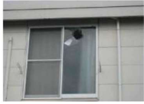
窓ガラスの飛来物衝突痕
