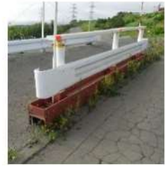
ガードレール
