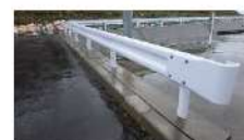
ガードレール
