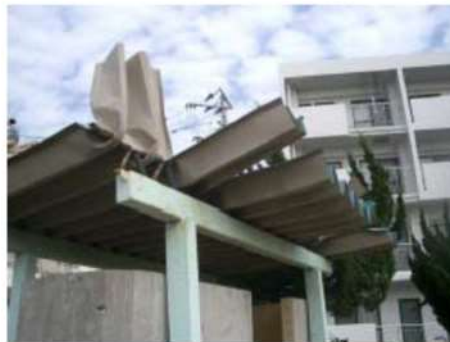
屋外トイレ屋根の損傷
