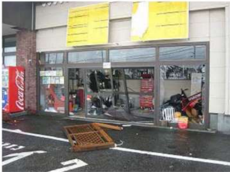
エントランスのガラス破損
