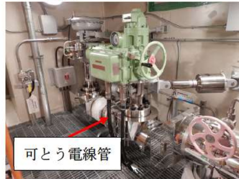
機器へのケーブル取合い状況 (電動弁との取合い)
