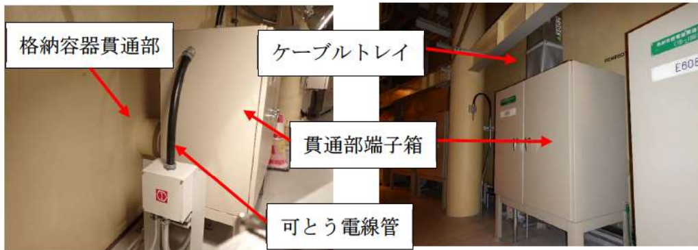
機器へのケーブル取合い状況 (格納容器貫通部とケーブルトレイ・電線管との取合い)
