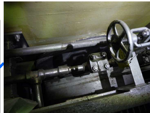
格納容器との接続部
