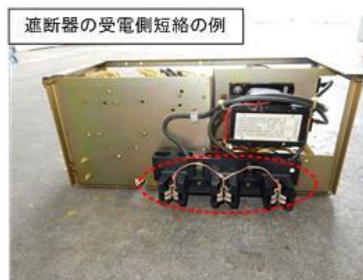
図 4-11 遮断器の短絡箇所 (MCC 試験時)
