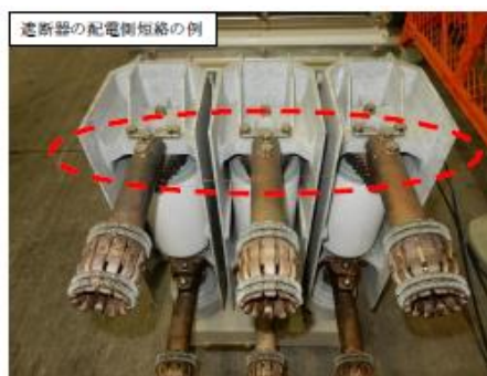
図 4-12 遮断器の短絡箇所 (M/C(D/G)試験時)
