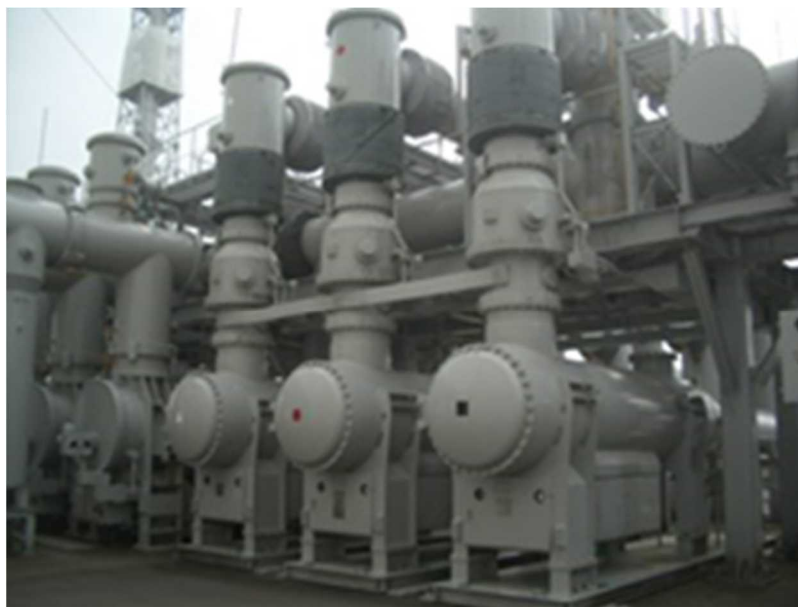
図3-9 500kV超高圧開閉所の外観
