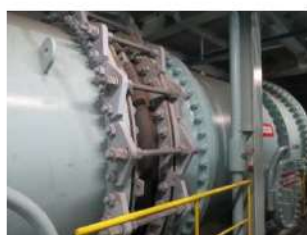
循環水管伸縮継手
