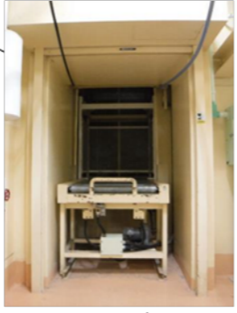
シャッター (乙種防火戸) (保守作業中につき シャッター開状態)
