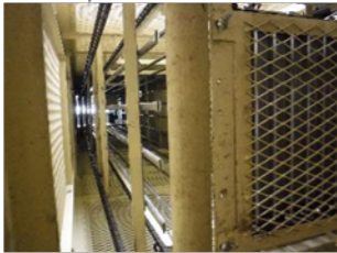
天井方向 (カートン搬入リフト)
