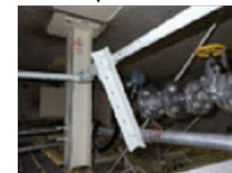
①温度記録上限緊急操作装置(熱電対)
