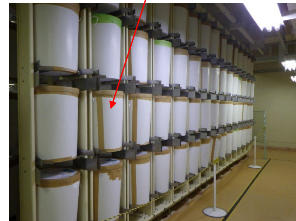
焼却炉運転時の一次貯蔵ラック(342M152)の状況 (運転時は、低放射性固体廃棄物を自動搬送する。)
