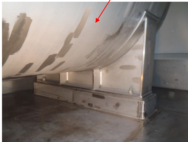
受入貯槽(328V10)の設置状況 (脚部)
