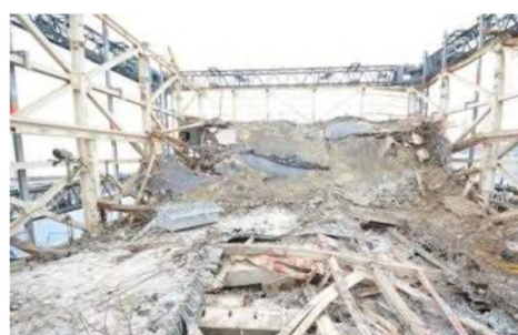
南側崩落屋根の状況
