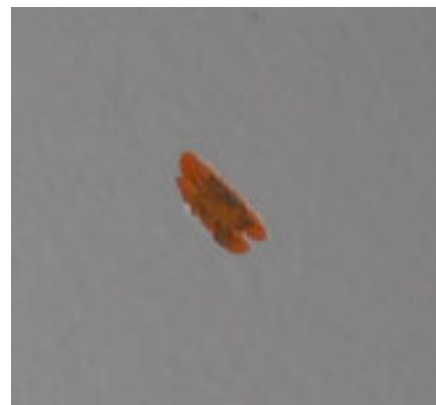
フロー③と判断した塗膜の劣化
