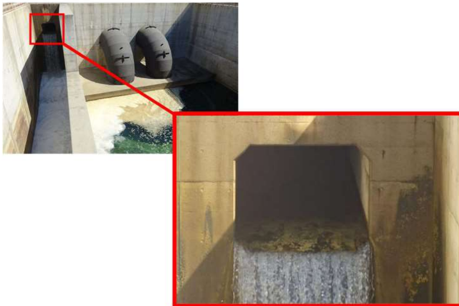
写真1 3号炉原子炉補機冷却海水放水路の海洋生物の付着状況
