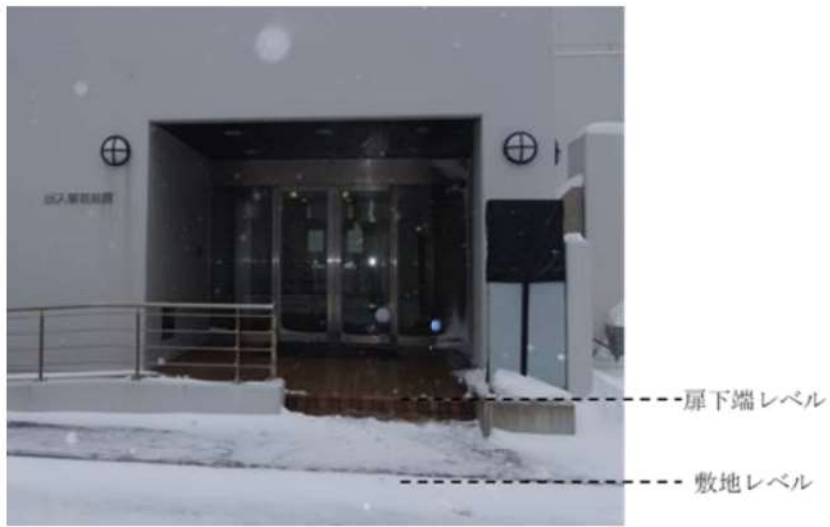
図3 建屋外壁扉（代表例）
