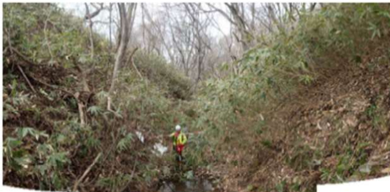
P3 防災科研調査において地滑り土塊末端部とされる箇所の状況 沢を挟んだ兩岸において斜面の角度が同程度であり、地滑り土塊末端部を示唆する先端部の押し出しは認められない。
