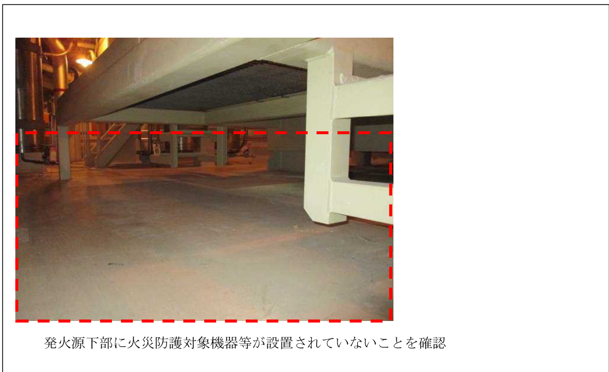
図4 主蒸気内側隔離弁下部
