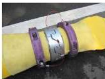
③ 可搬型ホース接続 (接続後)
