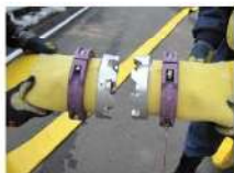
② 可搬型ホース接続 (接続前)
