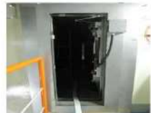
⑤ 可搬型ホース～復水ピット
