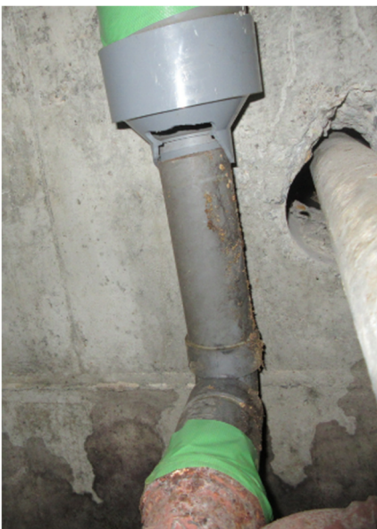
脱落箇所 B 仮養生後 (2022年8月4日実施)
