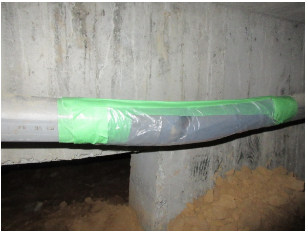
破断箇所 A 養生後 (2022年8月4日実施)
