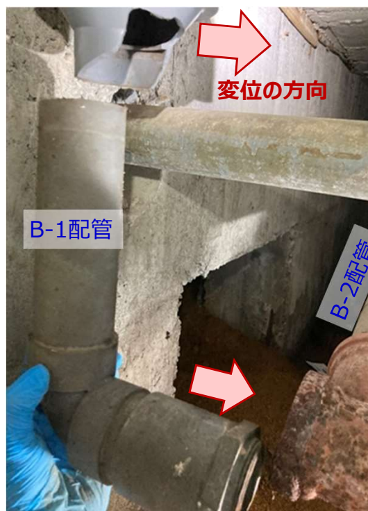
脱落配管B 脱落前状況 (再現)
