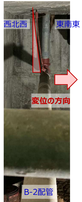
脱落配管B 上流側吊り金具部分
