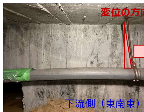
破断配管 A下流側吊り金具
