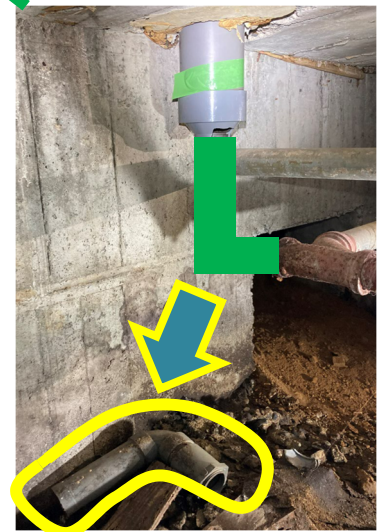
脱落箇所 B
