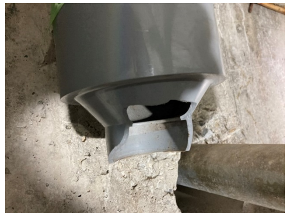
【レデューサー破損部】
