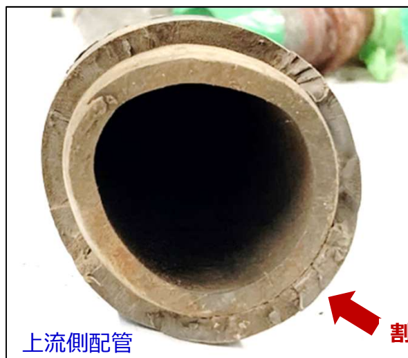
破断配管A 上流側ソケット破断面
