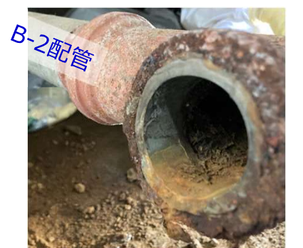
脱落配管B 鋳鉄チーズ破断部
