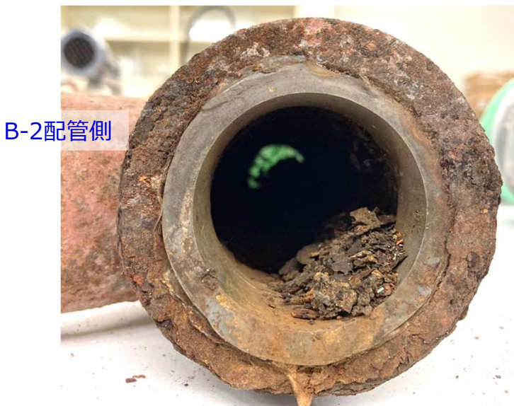
脱落配管B バルブソケット铸铁チーズ側破断面
