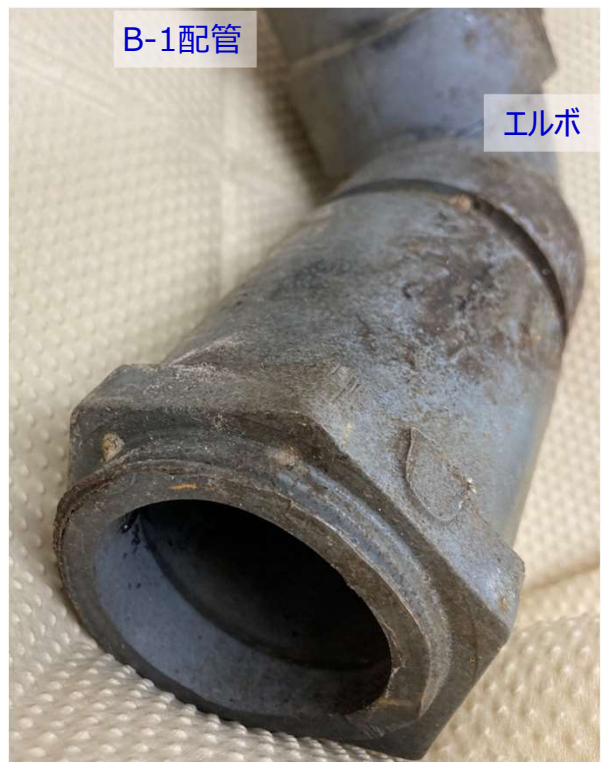
脱落配管B バルブソケット破断面
