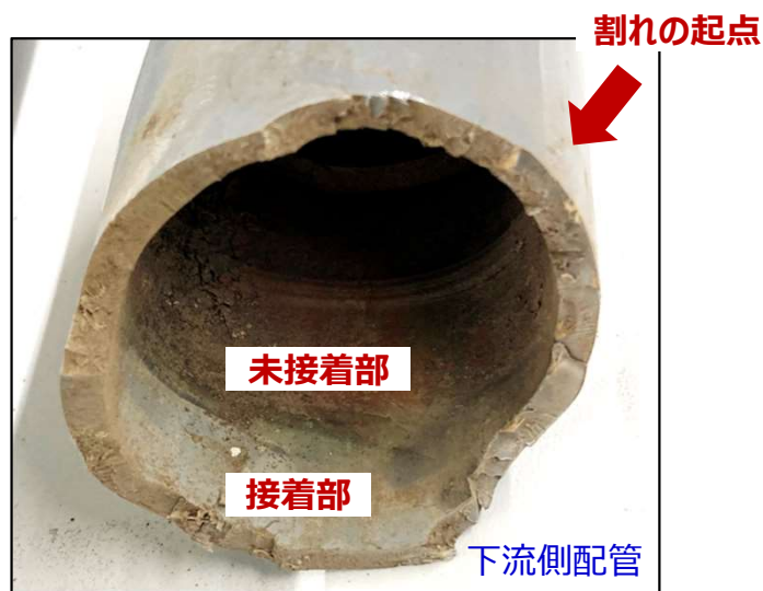
破断配管A 下流側ソケット破断面
