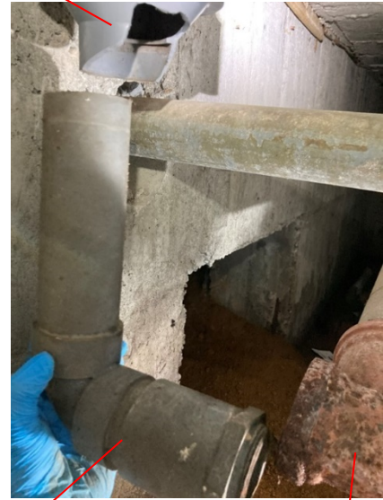
【脱落箇所B】
