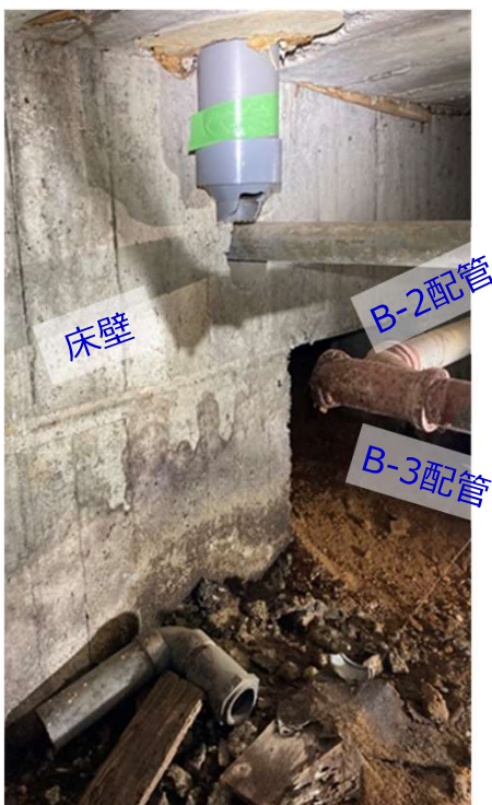
脱落配管B 脱落状況
