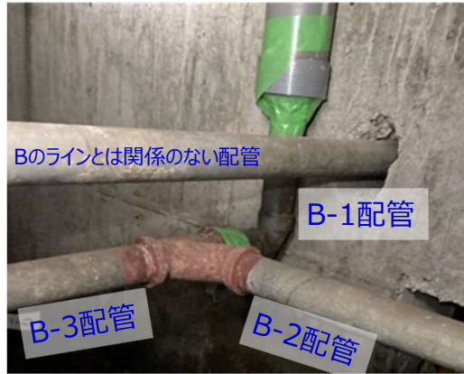
脱落配管B 脱落前状況 (現場写真)
