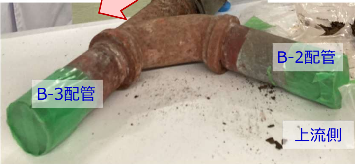
脱落配管B 脱落前状況 (床壁面を背面して観察したものを再現)
