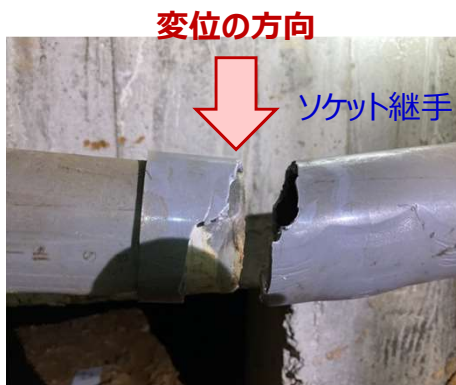
破断配管A 破断部
