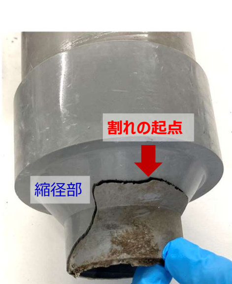
脱落配管B レデューサー破断状況
