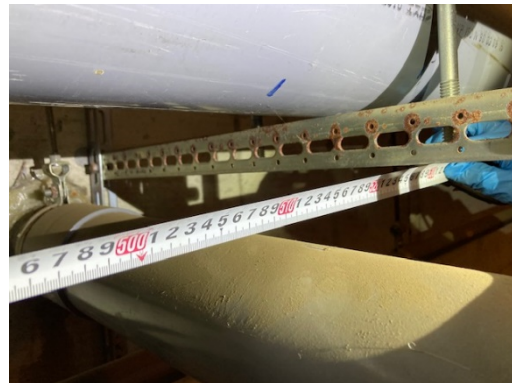
【写真4 振れ止め支持】
