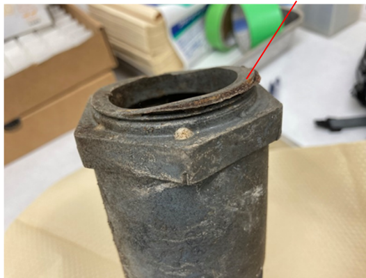
【エルボ管バルブソケット破損状況】
