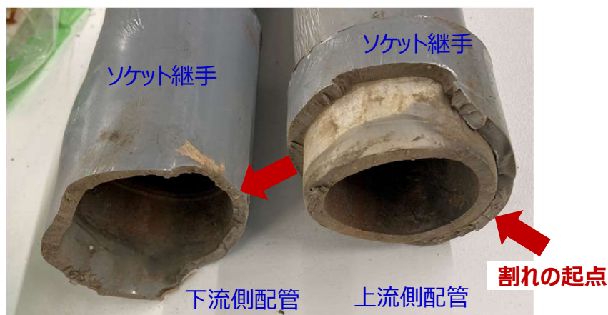
破断配管A ソケット破断面
