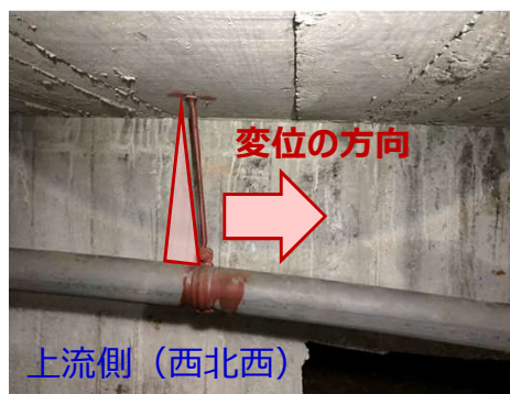
破断配管A 上流側吊り金具
