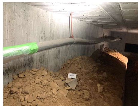
破断配管A全景
