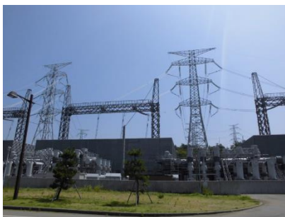
(a) 500kV 超高压開閉所
